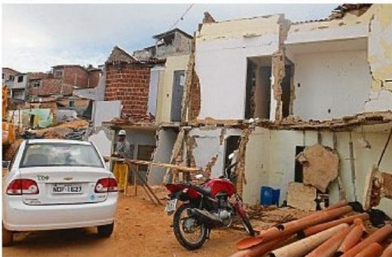
In Mae Luiza wurden viele Häuser bei einem Erdbeben beschädigt.
